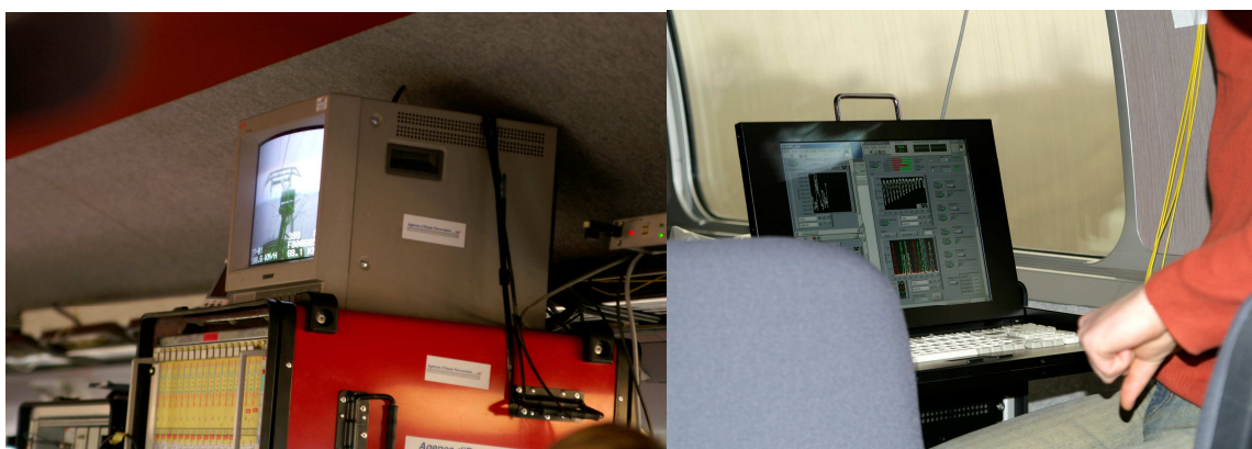
Figure 3: à gauche : moniteur de contrôle et système de mesure de la SNCF-AEF – à droite : système de mesure du CEA LIST (partie optoélectronique seule) – Projet SMITS
